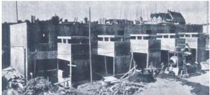
Figura 20. Obra de las casas 5 a 9, de Jacobus Pieter Oud. Este sistema es el que más requiere un proceso industrial en obra como el montaje de la torre para el vaciado del hormigón (1927)
