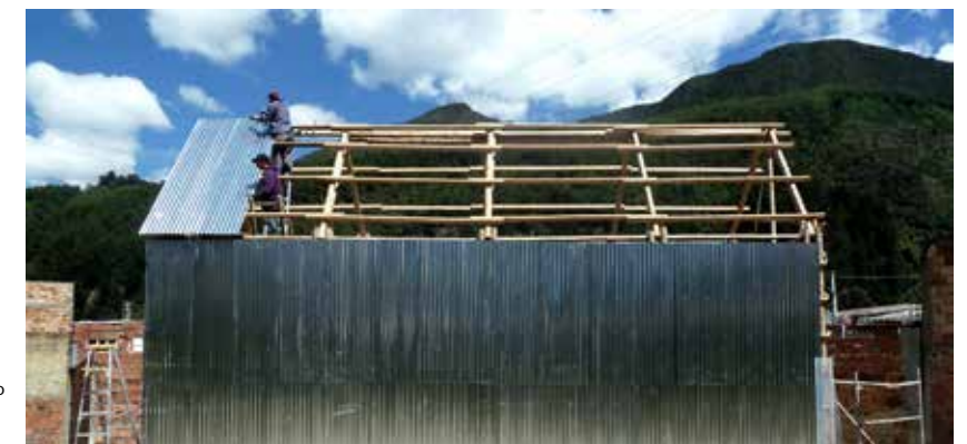
Casa de la lluvia [de ideas], barrio La Cecilia, San Cristóbal Sur, Bogotá.
